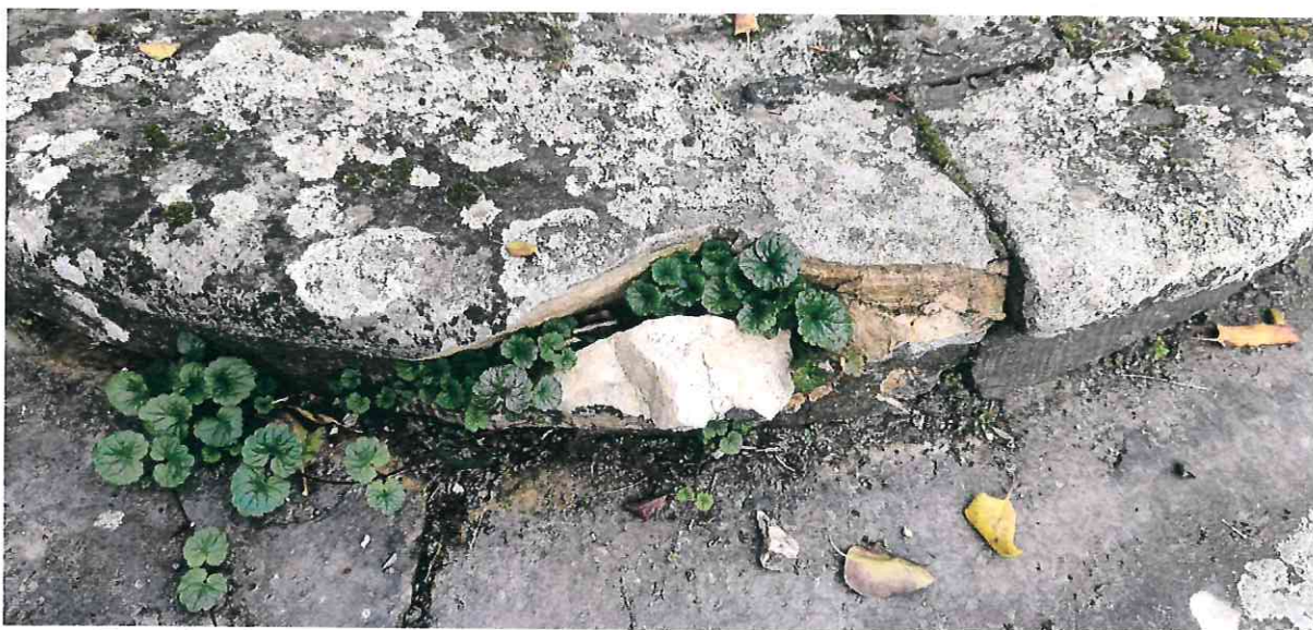
Fot. 19 Kolumna toskańska, stan zachowania postawy – pęknięcia płyty kamiennej.
