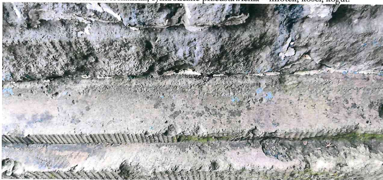
Fot. 18 Kolumna toskańska, zniszczenia w dolnej partii podstawy.
