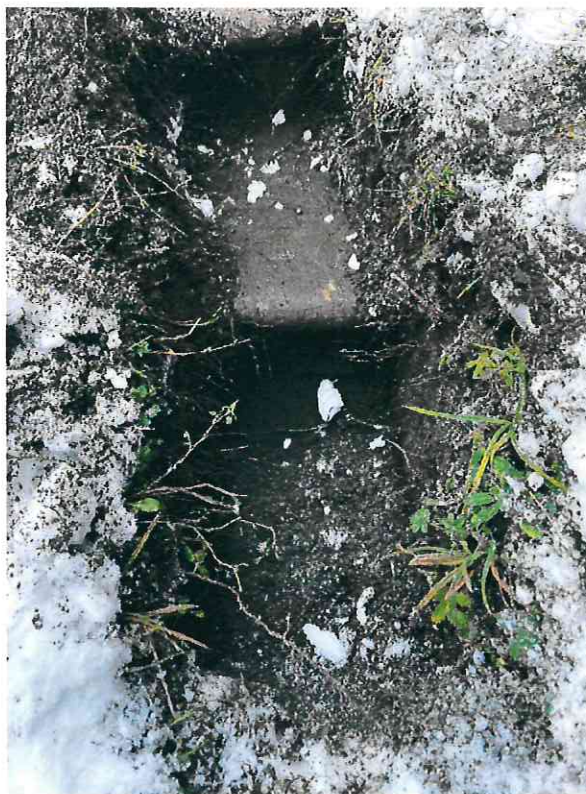
Zdj. 1 – Podstawa kolumny pokryta warstwą gruntu.
