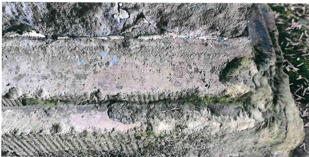
Fot. 4. Zniszczenia spowodowane wodą opadową.
