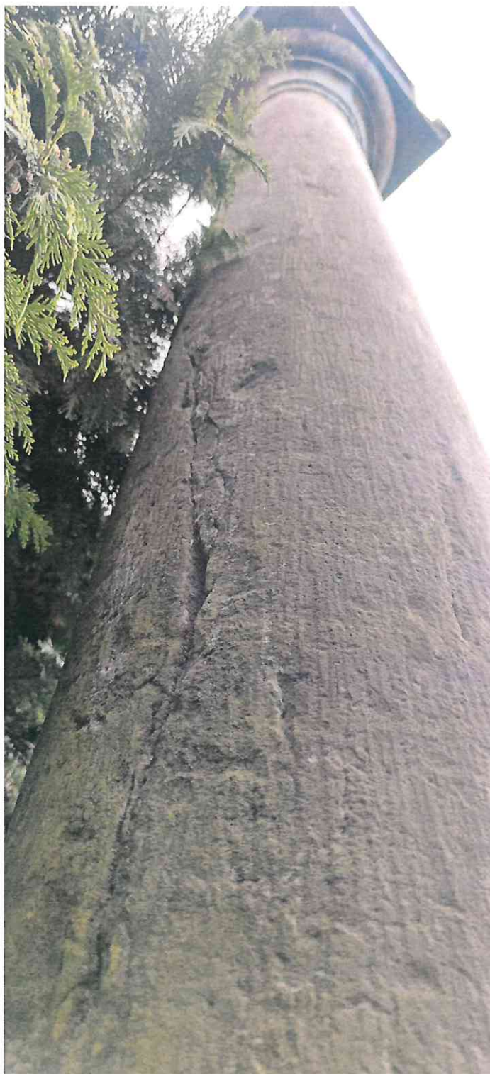
Fot. 5. Pionowe pęknięcie kolumny.
