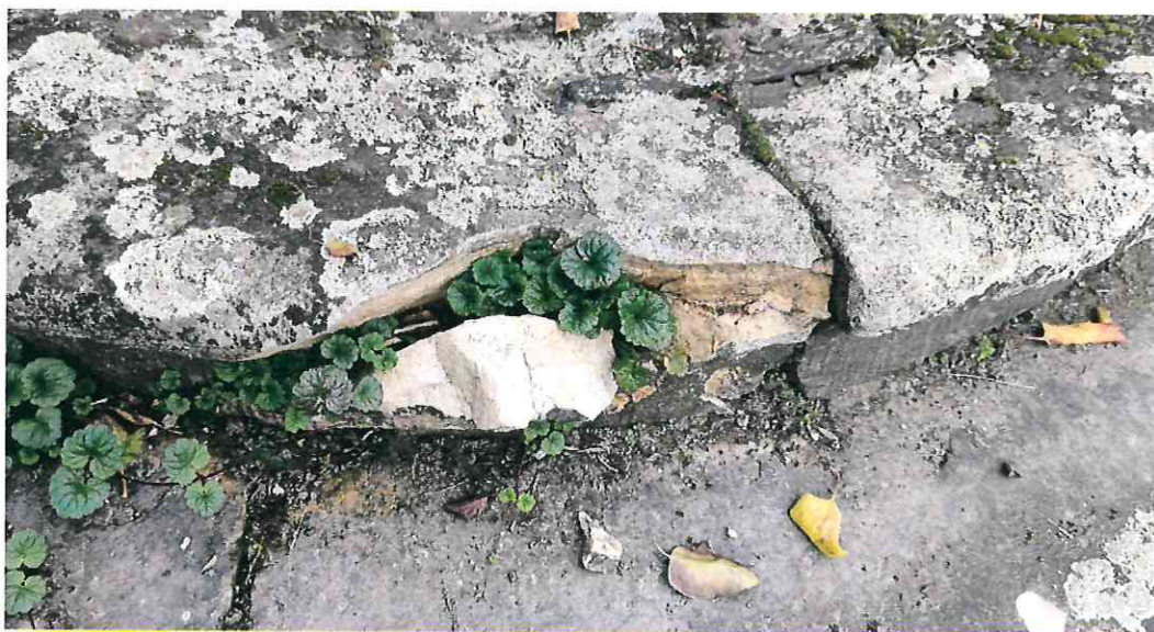
Fot. 3 Zniszczenia w obrębie podstawy obiektu.
