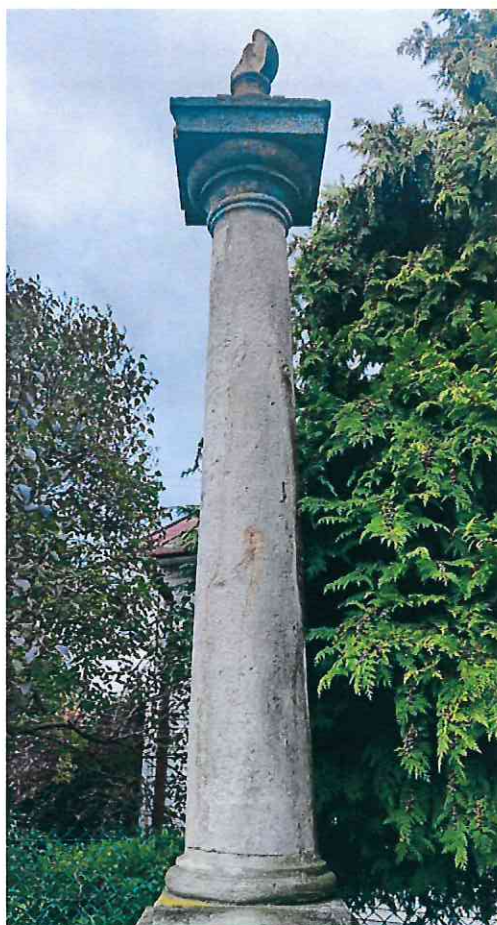
Zdj. 13 – Zabytkowa kolumna toskańska z widoczną erozją kamienia
