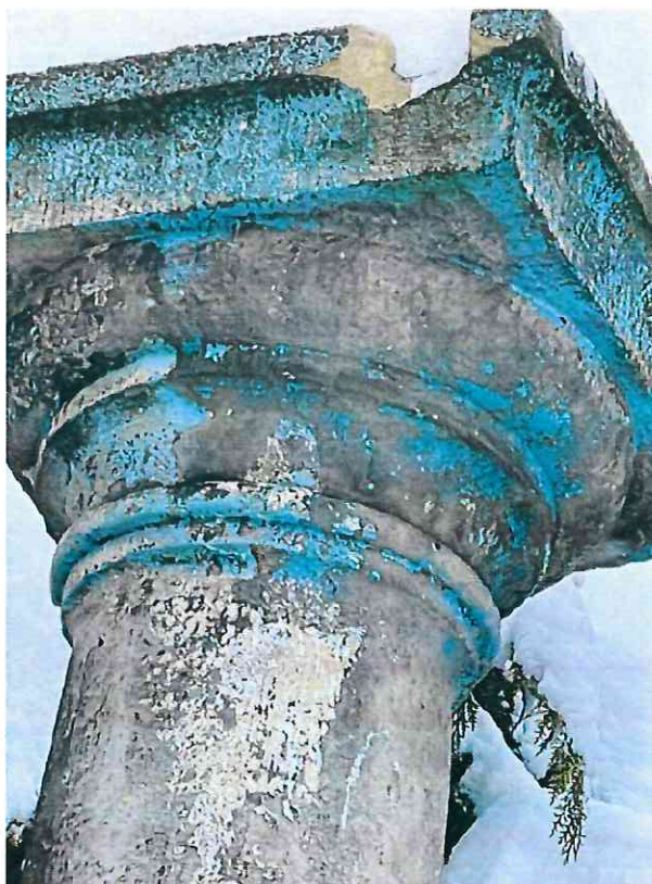
Zdj. 8 – Ubytek w górnej części kolumny
