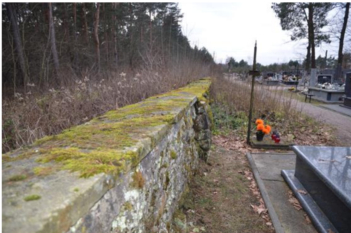
Fot. 17 Mur cmentarza– część południowa, deformacja, widok od strony wewnętrznej.
