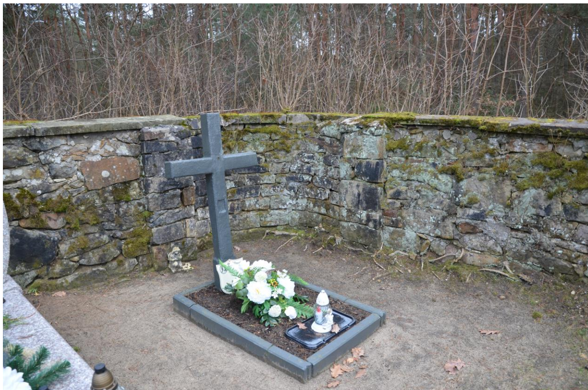
Fot. 14 Mur cmentarza, obluzowane kamienie – naroże południowo- wschodnie, widok od strony zewnętrznej. .
