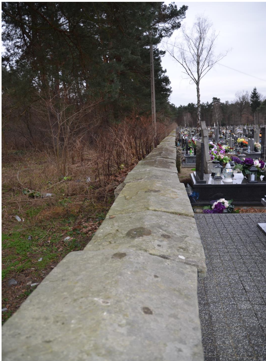
Fot. 4 Przechylenie konstrukcji.
