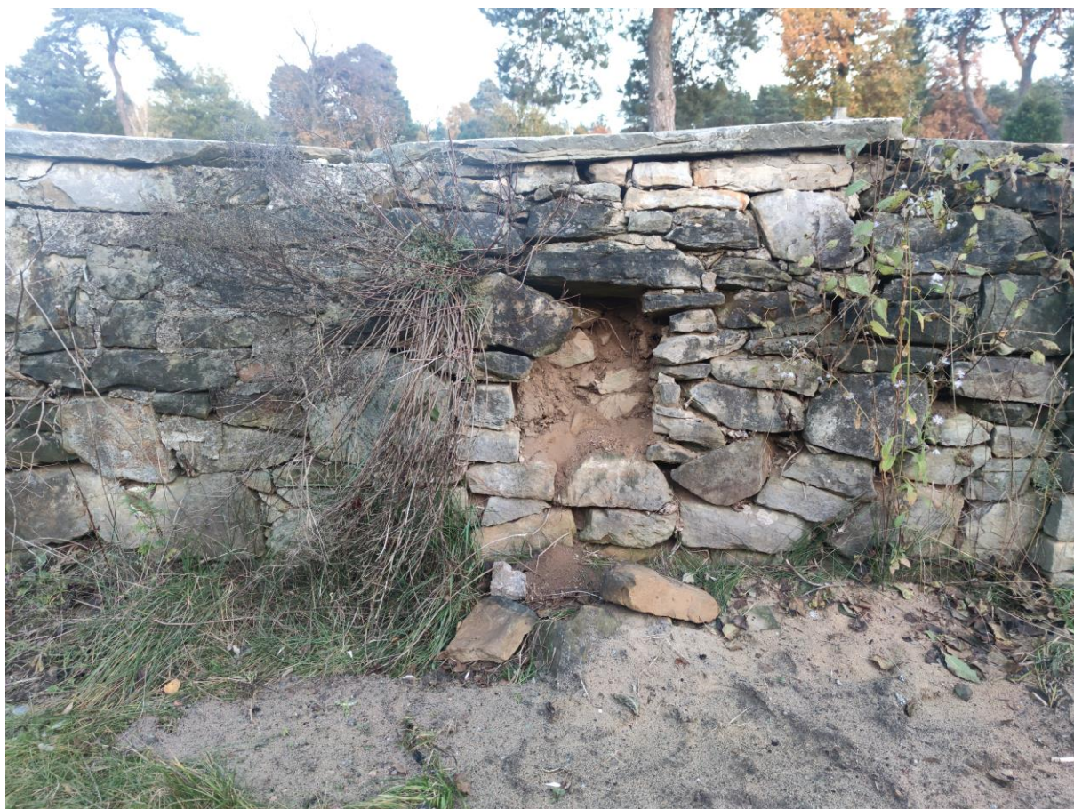
Fot. 3 Zniszczenie struktury muru ukazujące część wewnętrzną, część zewnętrzną strona zachodnia.
